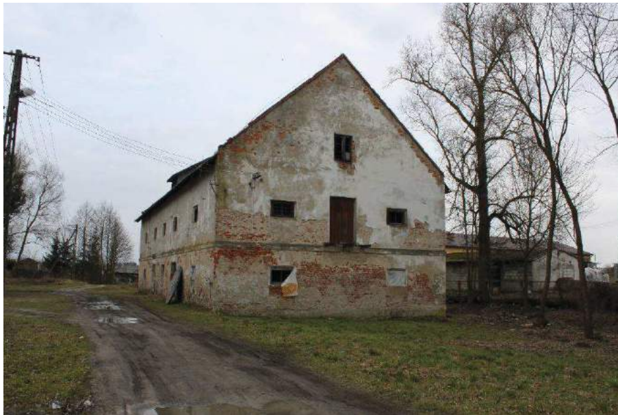
Fotografia 8 Zdegradowane budynki dawnego spichlerza – Osiedle Nowe Siolo
